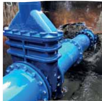
ARMATURNÍ ŠACHTA LHOŤA
